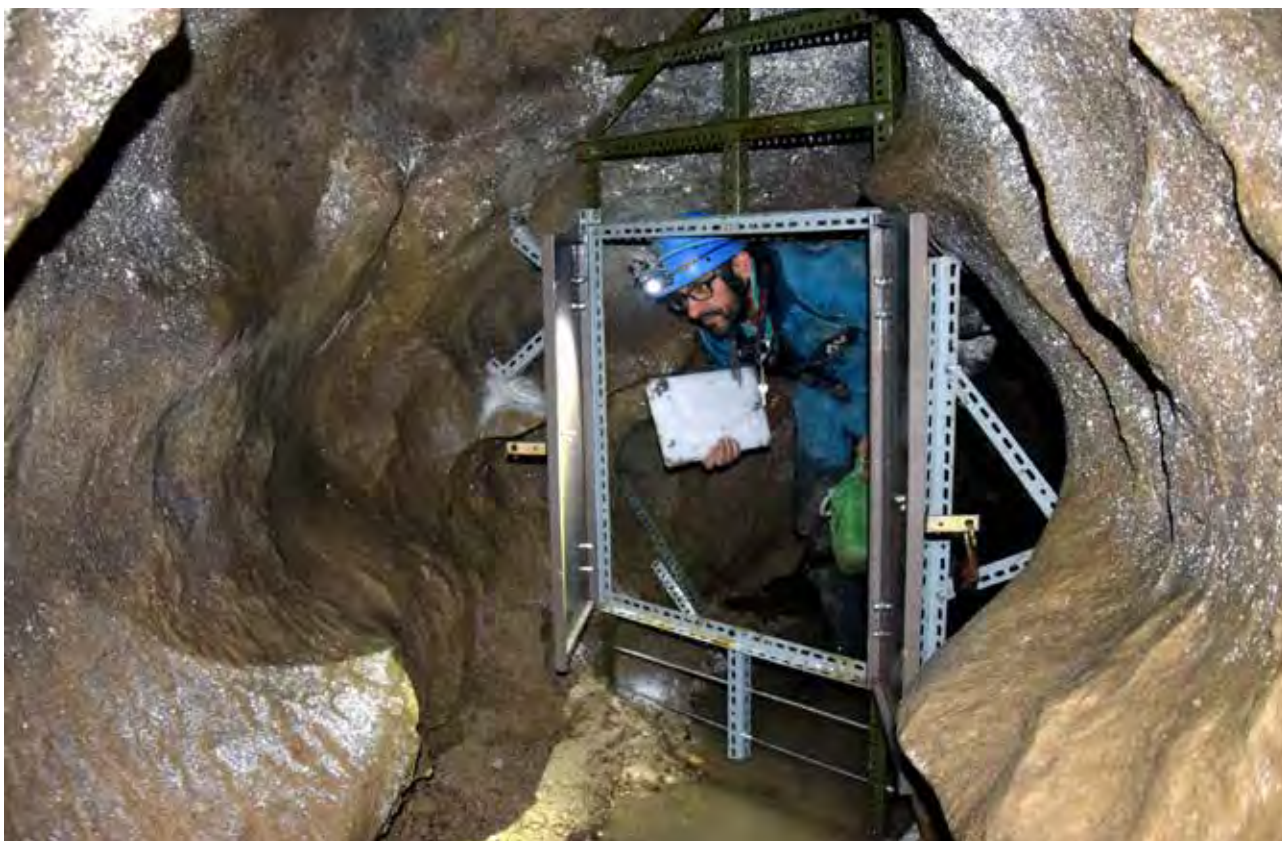
Fig. 14 – Cannello installato presso l'apporto in sinistra idrografica a protezione della stazione di misura (foto E. Sfrisi).
